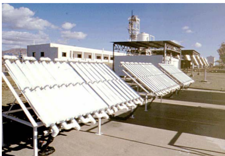
Σχήμα 8.26: Φωτογραφία της εγκατάστασης φωτοκαταλυτικής επεξεργασίας αποβλήτων παρουσία ηλιακού φωτός.Καταλύτης \text{TiO}_2 σε μορφή αιωρήματος, Plataforma Solar de Almeria.
