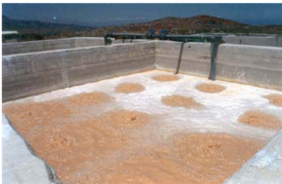
Σχήμα 8.28: Μονάδα φωτοκαταλυτικής επεξεργασίας στραγγισμάτων στο χώρο υγειονομικής ταφής απορριμμάτων στο Δήμο Ρεθύμνης, Κρήτη.
